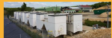
Unité de traitement et de valorisation
