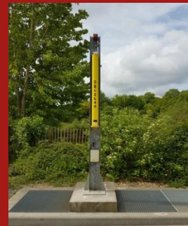
Portique de détection de radioactivité
