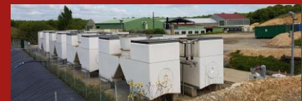
Unité de traitement et de valorisation
