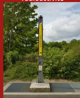
Portique de détection de radioactivité
