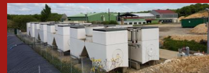
Unité de traitement et de valorisation
